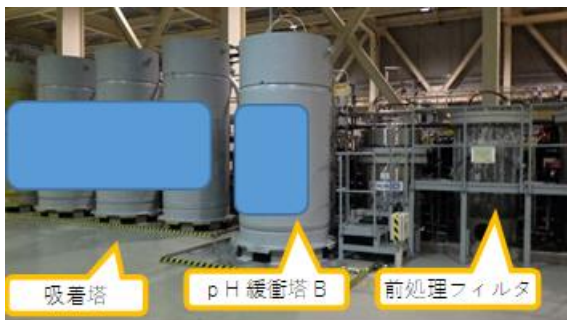
(写真 2-2) サブドレン他浄化設備 (B系) の 状況
