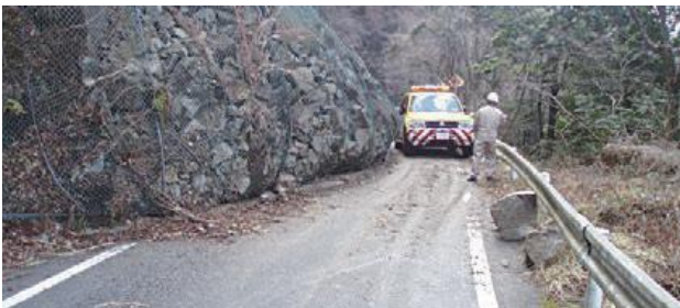
法面崩落〔県道小野四倉線〕
