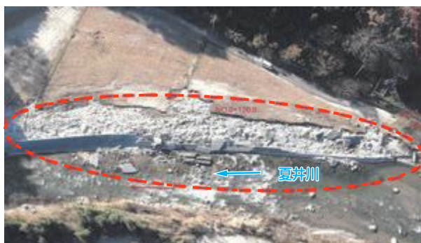
夏井川（小川町上小川） 被災状況
