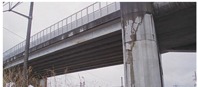
橋梁損傷〔植田跨線橋(県道日立いわき線)〕
