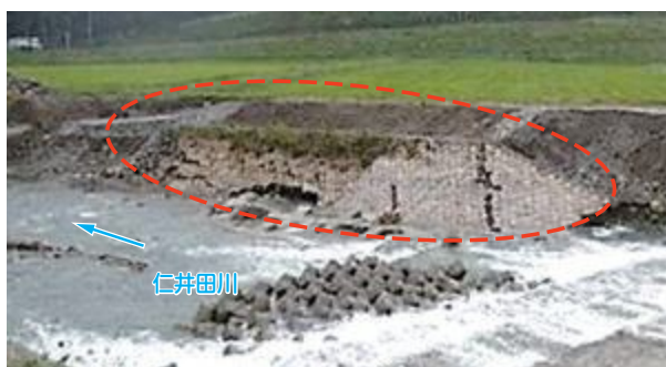
仁井田川（四倉町上柳生戸沢） 被災状況
