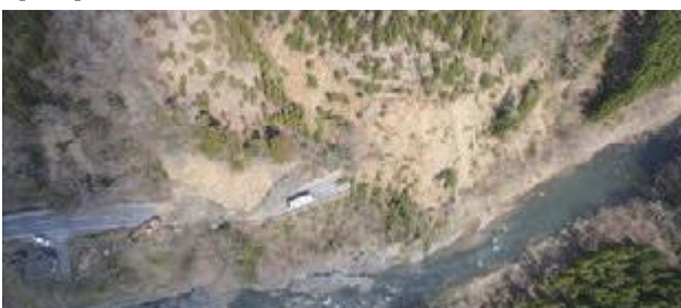
地すべり崩落〔県道いわき石川線(才鉢地区)〕4/11地震
