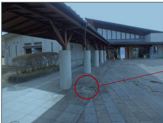
破損及び段差発生箇所
