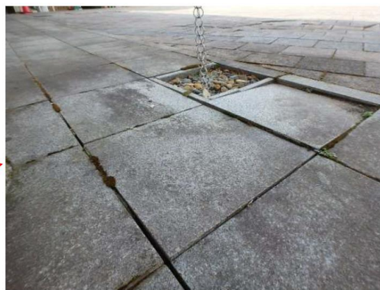
雨水枡破損箇所及び敷石段差
