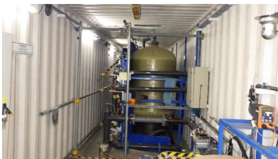
(写真4-2) コンテナ内の設備の状況
