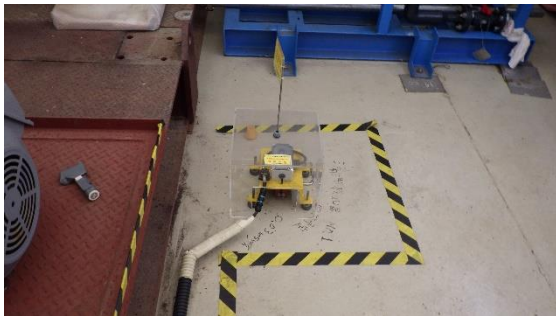
(写真5-1) 漏えい検知器の状況
