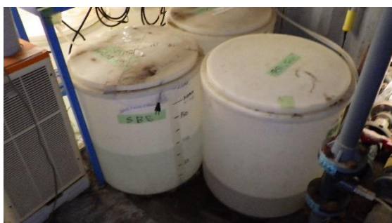
(写真 2 - 3) コンテナ内の薬品の保管状況
