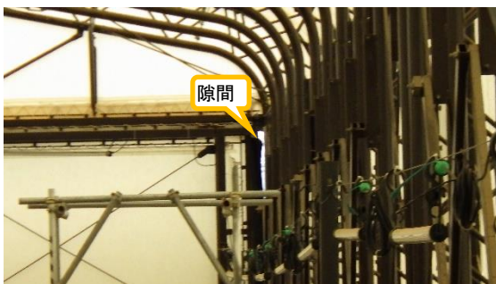
(写真5-2) 建屋の隙間の状況
