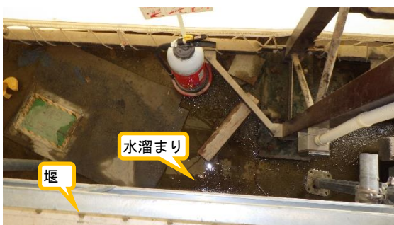
(写真5-3) 建屋内の水溜まりの状況
