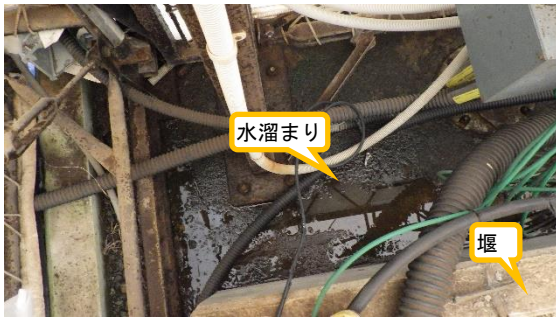
(写真3-3) 建屋内の水溜まりの状況
