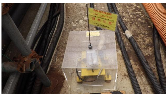
(写真 3 - 1) 漏えい検知器の状況
