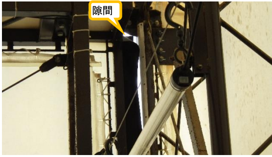
(写真3-2) 建屋の隙間の状況
