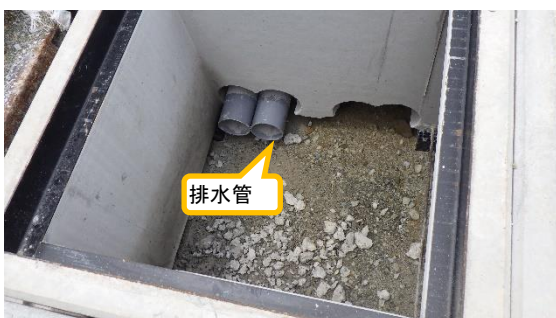
(写真 3 - 2) 排水枡内部の状況
