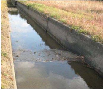
底版が隆起した水路
