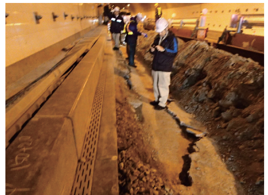
破壊されたインバートコンクリート
