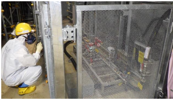
(写真6) 3号機窒素封入設備の状況
