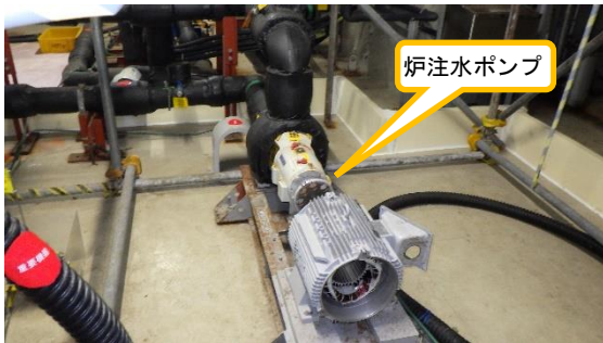
(写真 3 - 1) 2号機タービン建屋内炉注水ポンプ の状況
