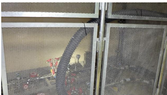
(写真 4) 2号機窒素封入設備の状況
