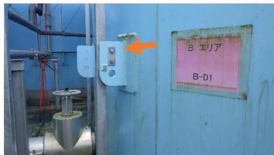
(写真2-2) 雨除けカバー支柱のボルト締結の状況 (写真2-1とは別の場所、今回(11月4日)撮影)
