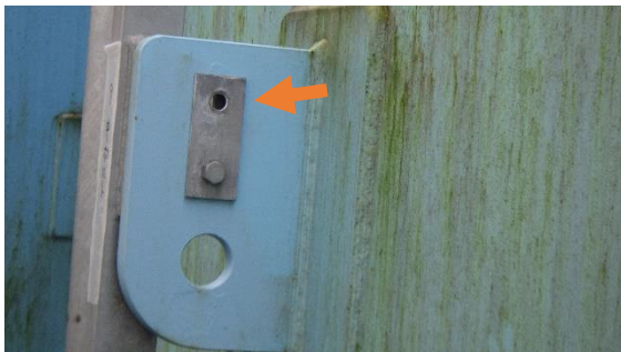
(写真2-1) 雨除けカバー支柱のボルト外れの例 (前回(7月27日)撮影)
