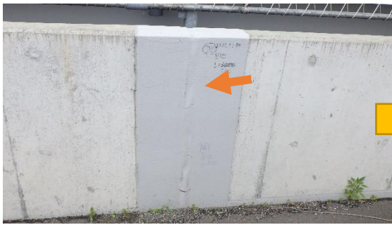
(写真4-1) 外堰被覆損傷の例（前回（7月27日） 南側から撮影）
