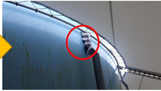
(写真3-2) 雨除けカバー支柱接触の状況（写真 3-1と同じ場所、今回（11月4日） 撮影）
