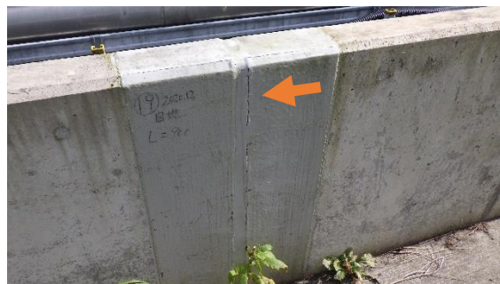
(写真4-4) 外堰被覆損傷の例（今回（11月4日） 撮影）
