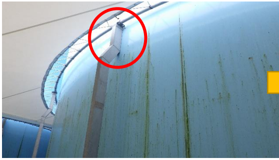
(写真3-1) 雨除けカバー支柱接触の状況（前回 （7月27日）撮影）
