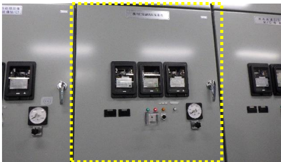
(写真3-2) 所内共通M/C 2 B 「構内配電線高圧配電棟」配電盤の状況
