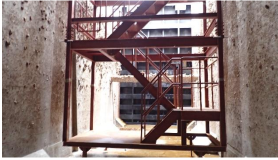
(写真1-1) 取水路の様子 ※陸側から海側に向かって撮影 手前の階段は地上と取水路内を昇降するためのもの
