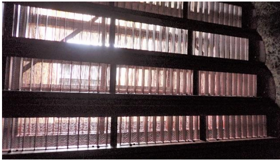
(写真1-2) 設置されたスクリーン設備の様子 ※陸側から海側に向かって撮影
