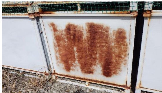
(写真3) 表面が劣化したコンテナの例
