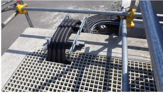
(写真 3 - 3) P S F 通信ケーブルの状況 (西側から撮影)
