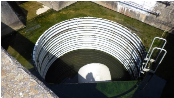
(写真 2 - 2) 集水枡 (固体廃棄物貯蔵庫第 1 棟西側) の状況 (南側から撮影)
