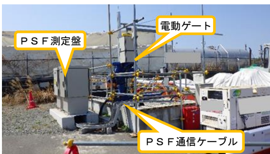
(写真 3 - 2) A排水路 P S F モニタ等の状況② (北東側から撮影)
