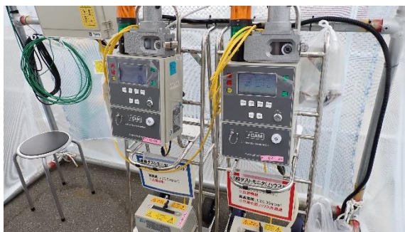
(写真2) ダストモニタの状況
