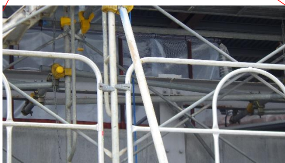
(写真4-2) 濃縮廃液貯槽 (ブルータンク) 上部のハウスの状況
