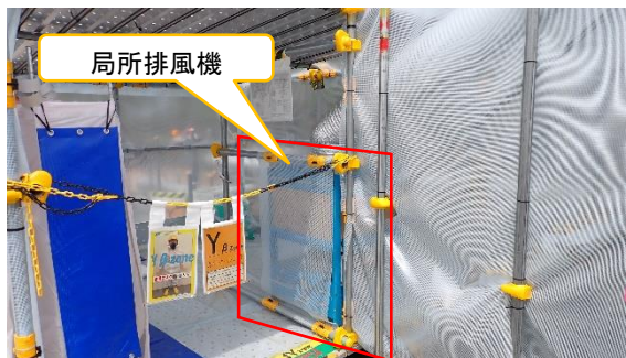
(写真1-3) 濃縮水タンクハウスにおける局所排風機の状況
