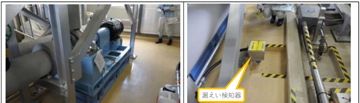
(写真1) 循環ポンプの設置状況
