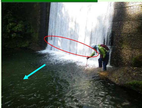
基礎洗掘状況
