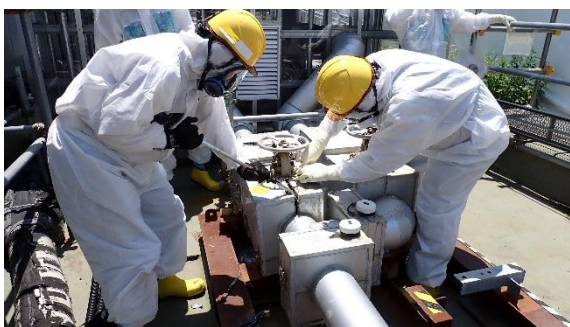
(写真 3 - 1) RO濃縮水供給ポンプ A出口弁の保温材取り外し作業状況
