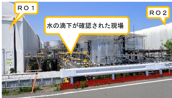
(写真 1) 水の滴下が確認された現場付近の状況 (南側から撮影)
