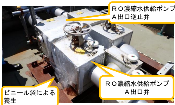
(写真 2 - 1) RO濃縮水供給ポンプ A出口弁の状況
