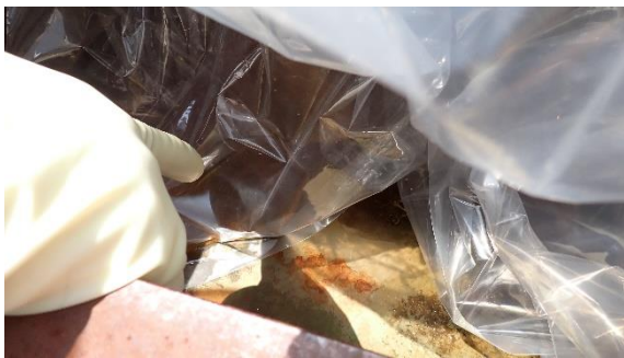
(写真 2 - 2) RO濃縮水供給ポンプ A出口弁下部に設置されたビニール袋の設置状況 滴下した水が補集されている
