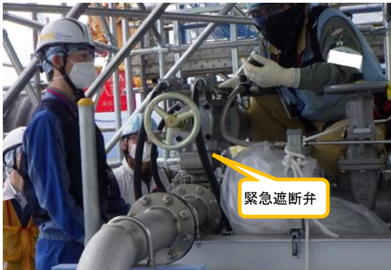
(写真3) 緊急遮断弁の動作確認の様子
