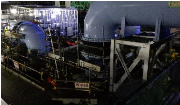
(写真 1 - 1) 海水移送ポンプの状況
