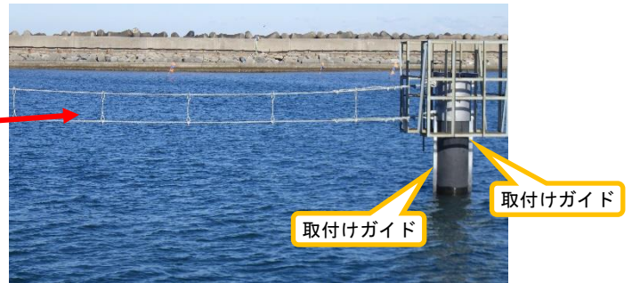
(写真5-2) ステンレスワイヤーの設置状況② (南西側から撮影)
