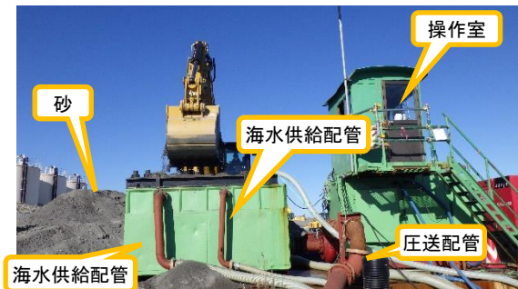
(写真1-1) 仮設プラントに砂を投入している状況 (南側から撮影)
