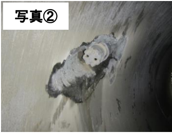
【ヒューム管内面貫通部】
