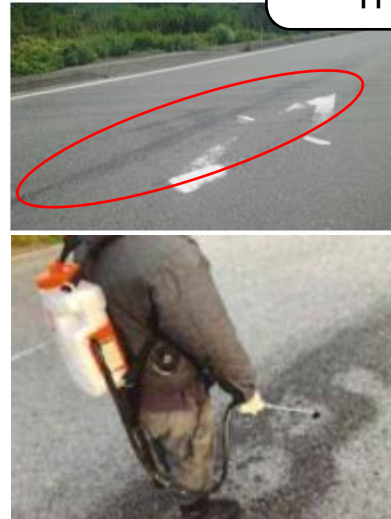
【漏出状況と中和処理】
