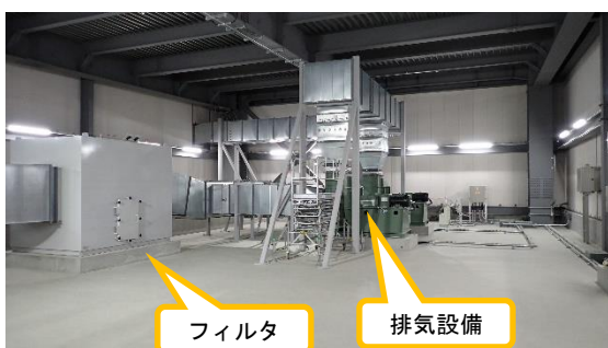
(写真5-1) 建屋2階排気設備の状況
