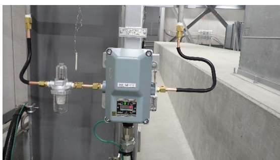
(写真5-2) 水素モニタの状況
