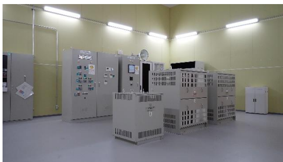
(写真4-2) 別棟内部電気設備の状況
