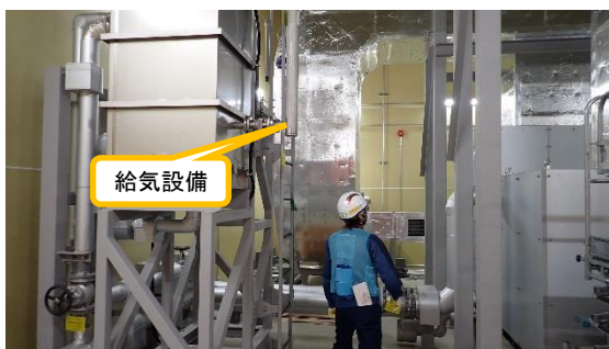
(写真4-1) 給気設備の状況
