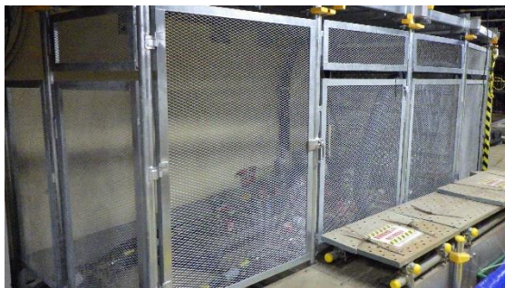
(写真4) 2号機窒素封入設備の状況
