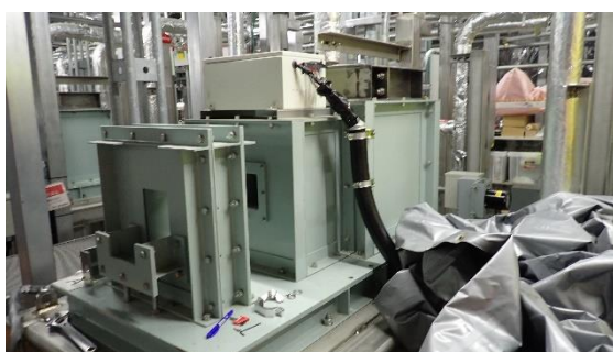
(写真1) 点検対象である希ガスモニタA系の 状況 (検出器が取り外されている)
