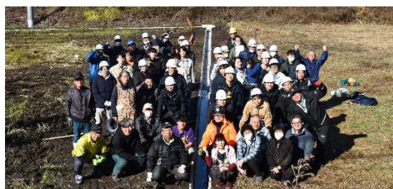
▲地域住民および協議会メンバー等による2次製品竹筋コンクリートU字溝の設置（南会津町）
