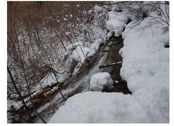
水路破損の様子
