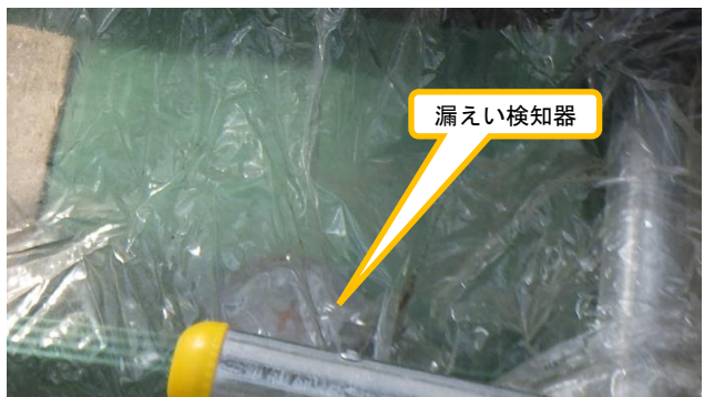
(写真2-2) 受けパン内に設置されている漏えい検知器。
