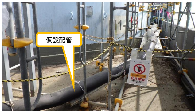
(写真1-3) H1タンクエリア堰内の仮設配管の敷設状況 (H1タンクエリア堰内南側を西方向から撮影)
