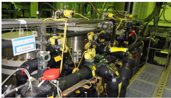
(写真6) 設備配管の一部
