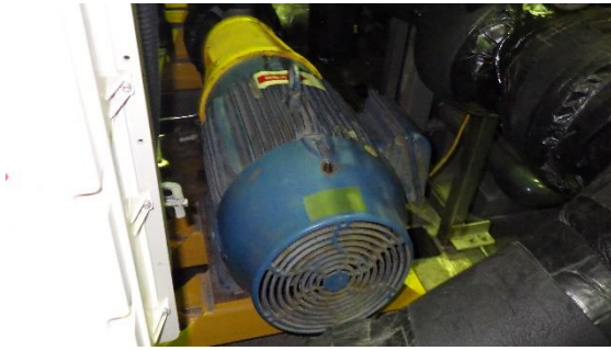
(写真5) 水を移送するポンプの状況
