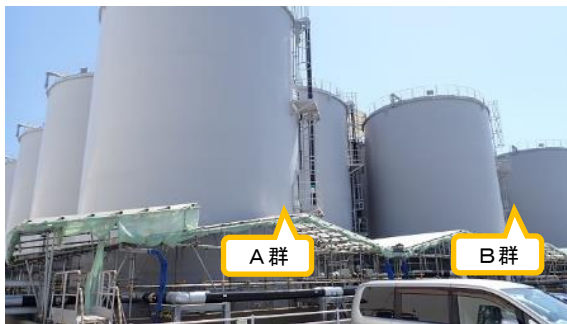
(写真1) 測定・確認用設備 (K4タンクエリア)
