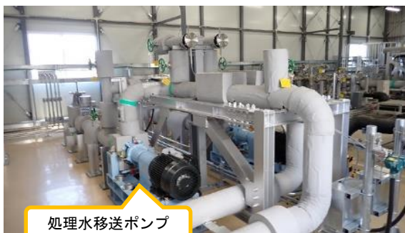
(写真2-1) 処理水移送ポンプ
