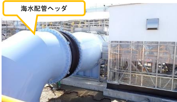
(写真 2 - 3) 海水配管ヘッド
