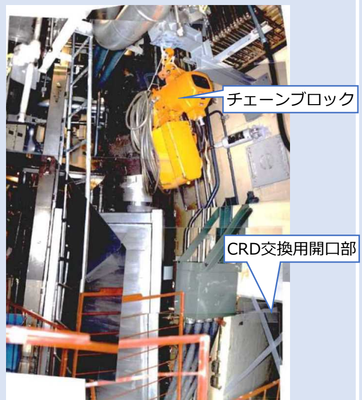
【震災前：定期検査時】CRD交換用開口部前 チェーンブロック
