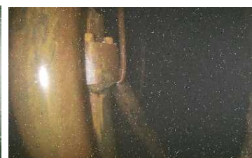
⑧：落下した構造物 B
