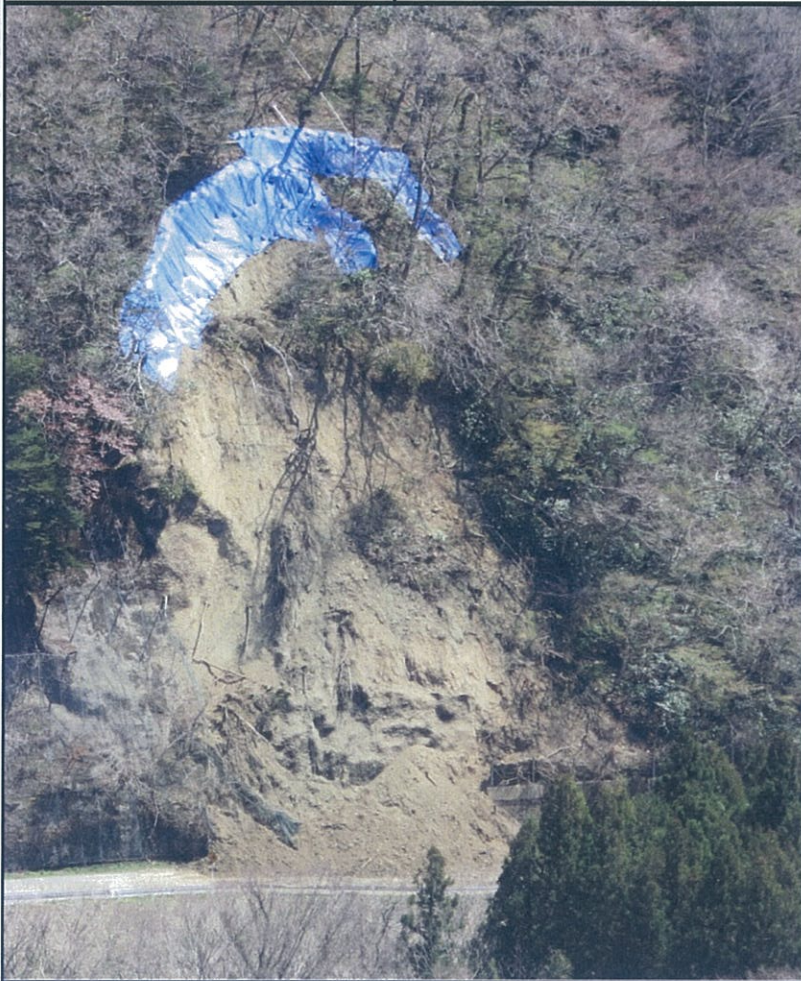
法面崩落状況写真①
