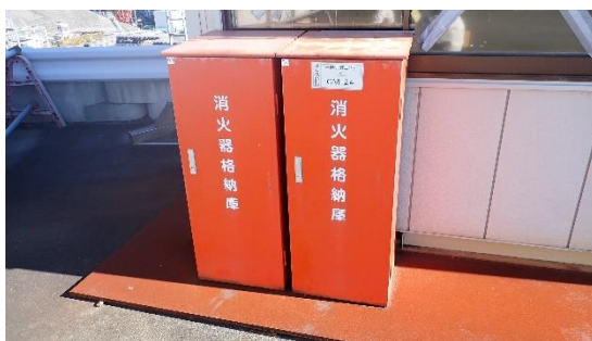
(写真 3 - 2) 消火器の設置状況
