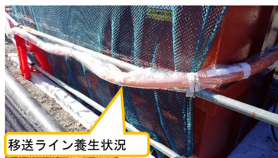
(写真3②) タンク移送ライン
