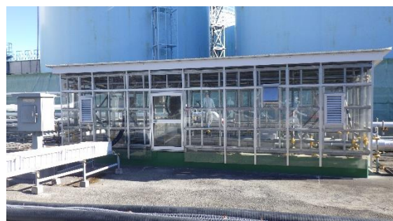
(写真2) 雨水回収ポンプ小屋
