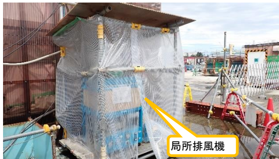
(写真5) 局所排風機の状況
