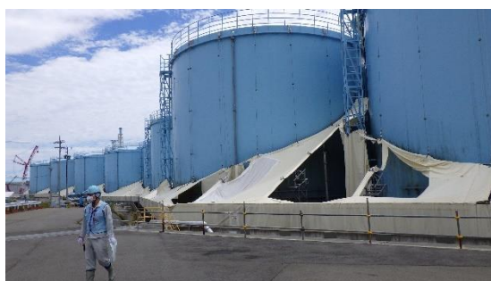
(写真6) H2タンクエリアの状況
