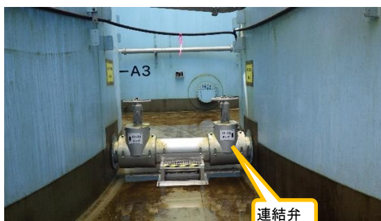
(写真8-1) 連結弁の状況①
