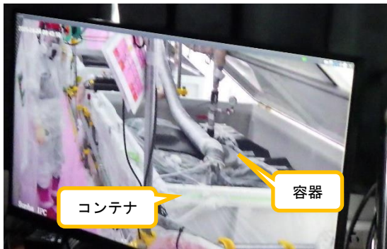
(写真3) スラッジ回収用のポリエチレン製 容器 ※ハウス内に設置されたカメラの 映像を確認。
