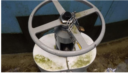
(写真 8 - 2) 連結弁の状況②
