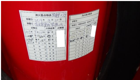
(写真 3 - 2) 消火器の点検記録
