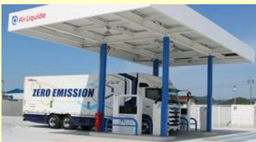
本宮インターチェンジ 水素ステーション
