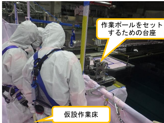
(写真1) 異物落下事象発生場所での確認状況
