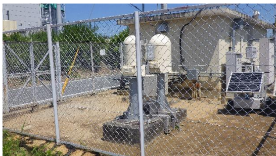
(写真5－1) モニタリングポスト No. 3の状況
