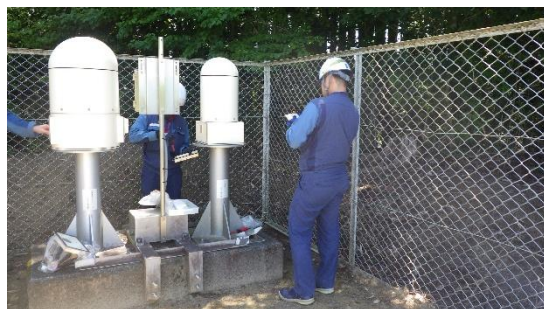
(写真5－2) モニタリングポスト No. 4の状況
