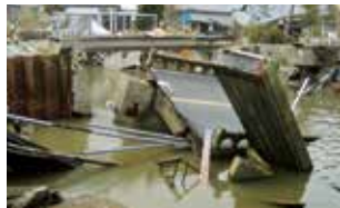
東日本大震災直後の小名浜・太平橋 (平成23年4月23日)(提供/いわき市)
