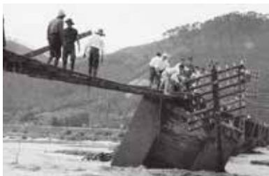
昭和23年9月13日 台風21号による洪水 流失寸前の電車の鉄橋(路面電車 福島・長岡〔伊達市〕間の松川鉄橋) (提供／福島民報社)
