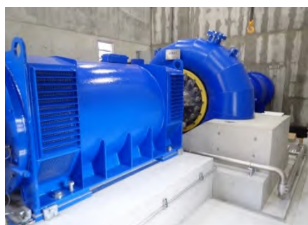
令和 6 年度より発電を開始した「請戸川水力発電所」 （浪江町）
