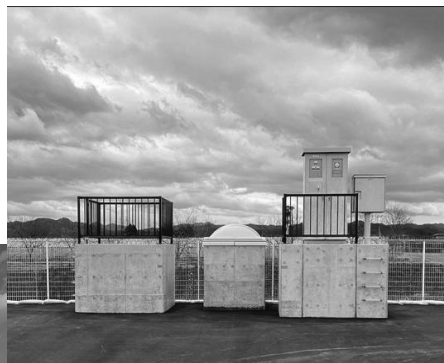
【伊達中継ポンプ場】
