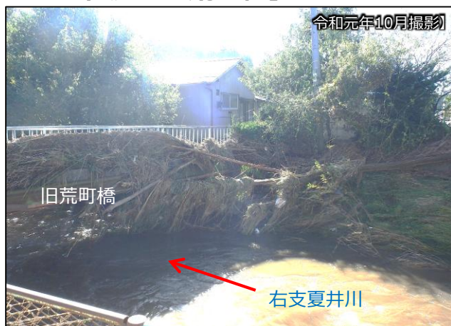
【出水状況：旧荒町橋】
