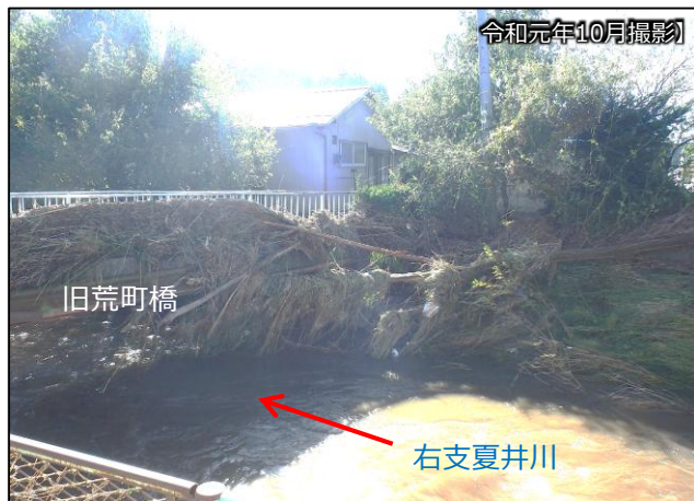
【出水状況：旧荒町橋】
