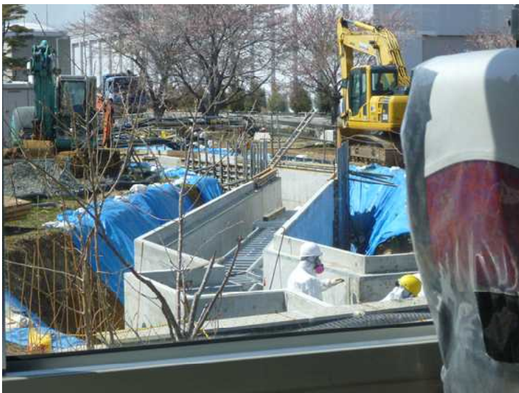
○ B・C排水路付け替え 排水路の排水口の状況確認
