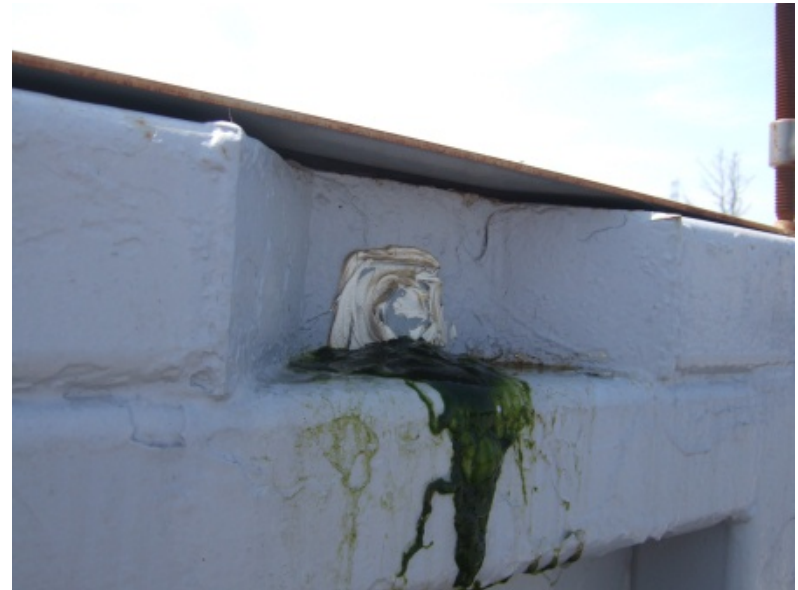
写真漏えい箇所
