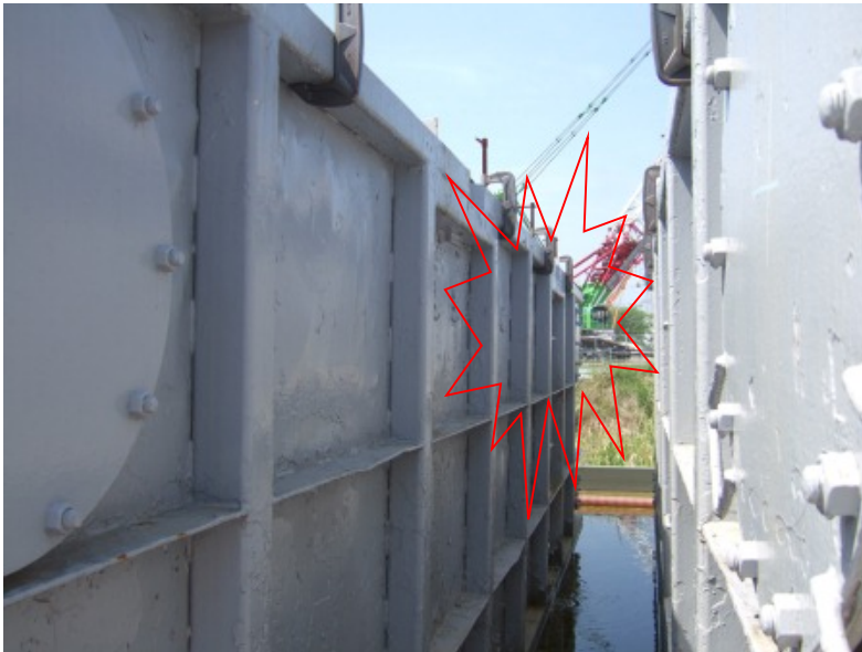
写真1:漏えいが確認されたノッチタンク
