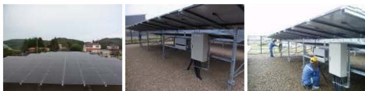
平成25年10月4日 太陽光パネル設置状況及びPC・交流集電盤
