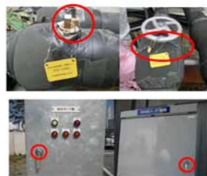
弁・電源盤の施錠管理
