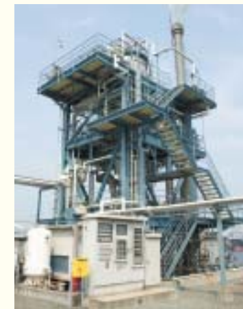
各工程で発生する廃油・廃液を自社で処理するための、ダイオキシン対策済みの新型焼却炉です。
