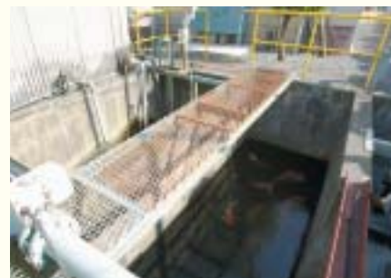
河川放流口の内ピットでは色巻を飼い、計器とともに排水を監視
