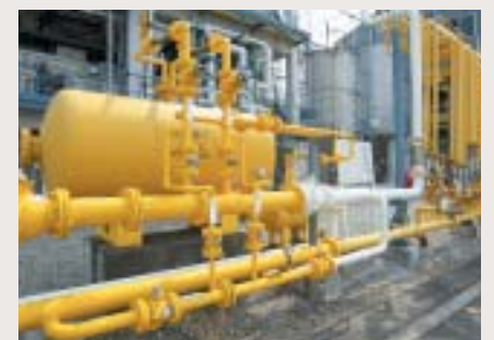
石油コンビナートの防災施設には、泡消火設備が各施設・タンクに配管で接続されています。防災訓練での反復訓練が重要な取り組みです。
