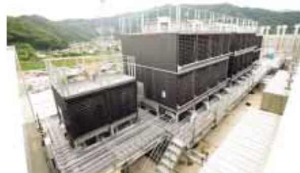
クーリングタワー設備
