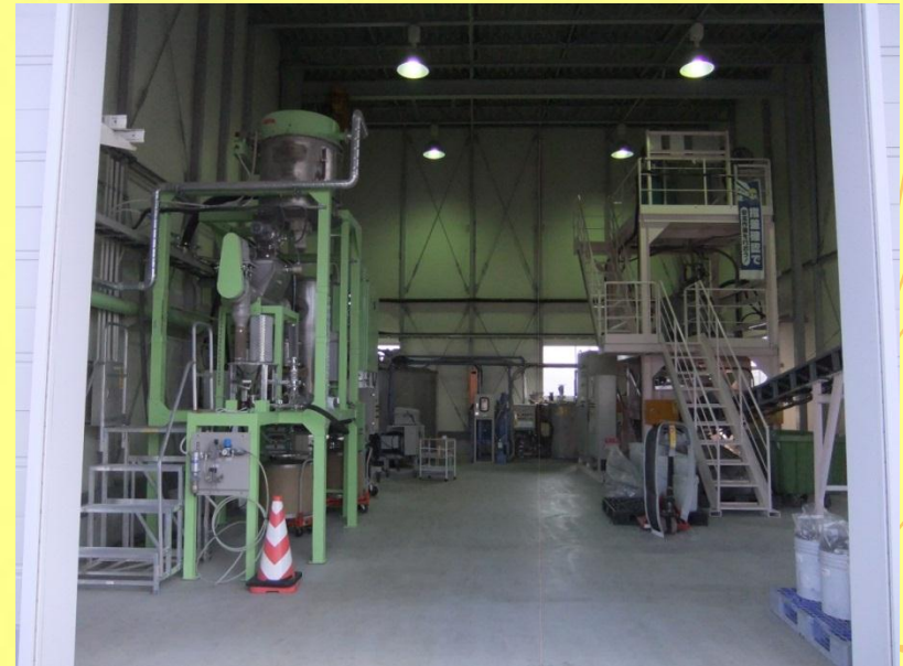
プラント内部: 洗浄設備(右)、分級設備(左)
