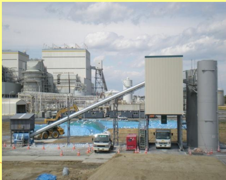
実証試験のプラント全景
